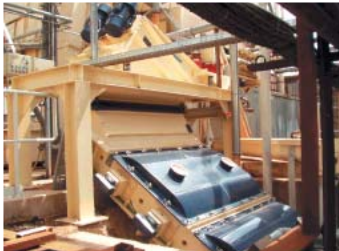
Bild 3: Die Siebanlage bestehend aus Verteilerinne und Sizer 2000
