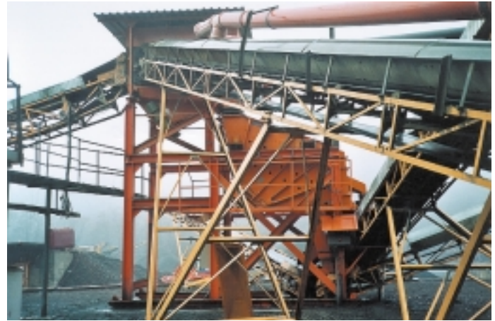
Bild 5: Betonwerk Lučka, Seitenansicht der 1. Siebstufe mit Sizer SL 1546
