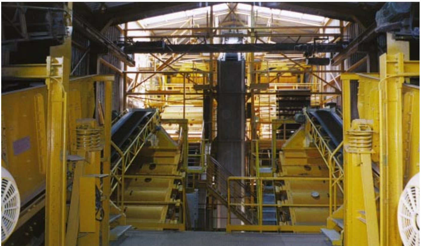
Bild 4: Die Feingutsiebanlage im Werk Nickenich
